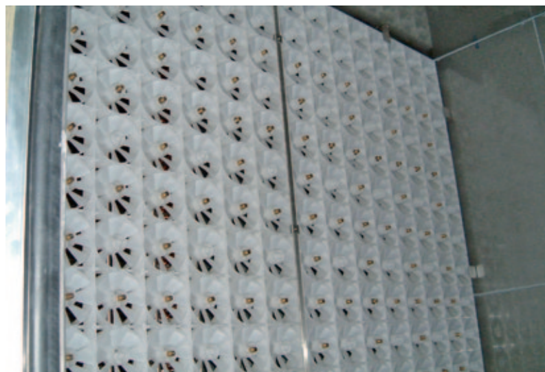
Ausführung eines Hochdruckbefeuchters
